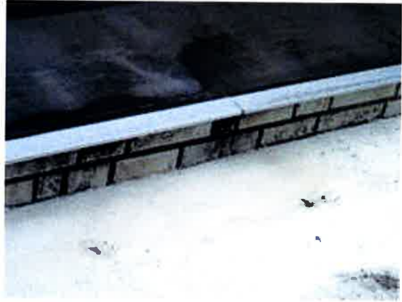
□笠木ジョイント部、下端の汚れ
