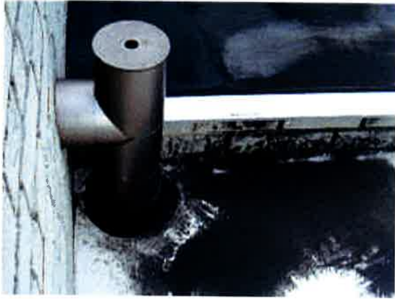
□屋上排水ドレン付近に堆積した汚染物質
